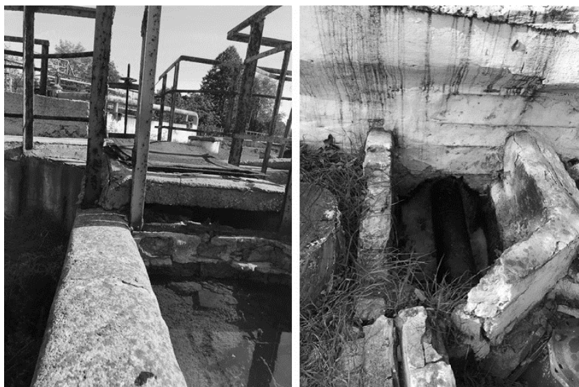
Рис. 1. Стан будівельних конструкцій діючих міських очисних споруд
